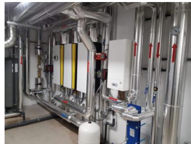
Geothermische installatie bij THB El Cid.
