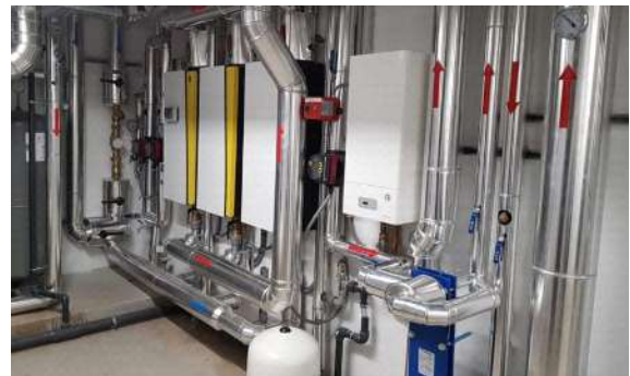
Instalación de geotermia en THB El Cid.
