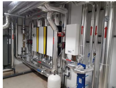
Geothermie-Anlage im THB El Cid.
